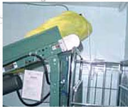
Figure 5 : convoyeur pour récupérer les poches de linge à la réception de la chute et les acheminer au chariot de transport.
